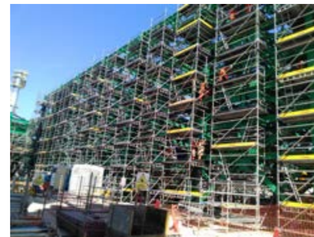
Vista general del andamio multidireccional BRIO como torres de acceso
